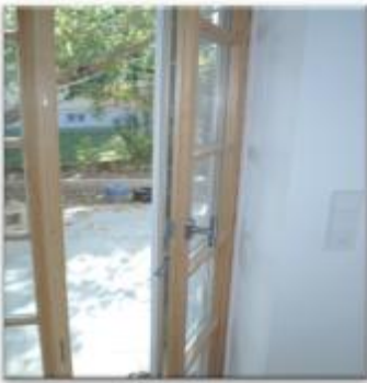
Fenster / Fenstertüren Leicht geöffnet mit Blick auf Beschlag
